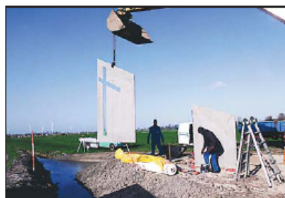
Die Firma Stahlbau Peters, Rodenkirchen, hat die Unsichtbare Sehenswürdigkeit Kloster Inte gebaut
